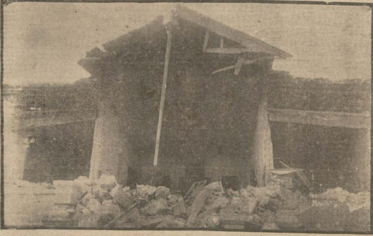
Bedbaht Erzincan'ın Ordu Müfettişliği binası bu haldedir. Sağlam kalan duvarda görülen resim Atatürk'ün resmidir. Duvara, resme ve resmin camına birşey olmamıştır.
